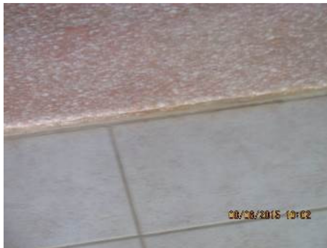
8.13. מדרגה בכניסה לממ"ד. מפגע בטיחותי
